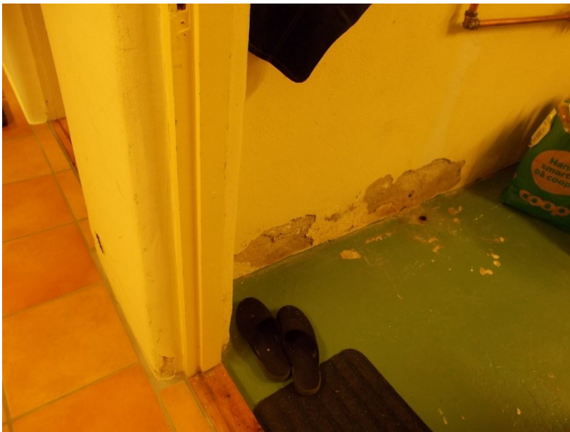
Figur 5.5 Bagarmossen: Putssläpp i källare där installation saknas
