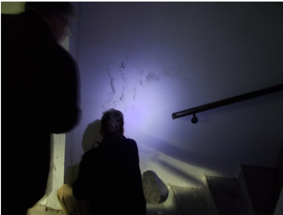
Figur 6. Röda korset: Den fuktiga väggen nära trappan
