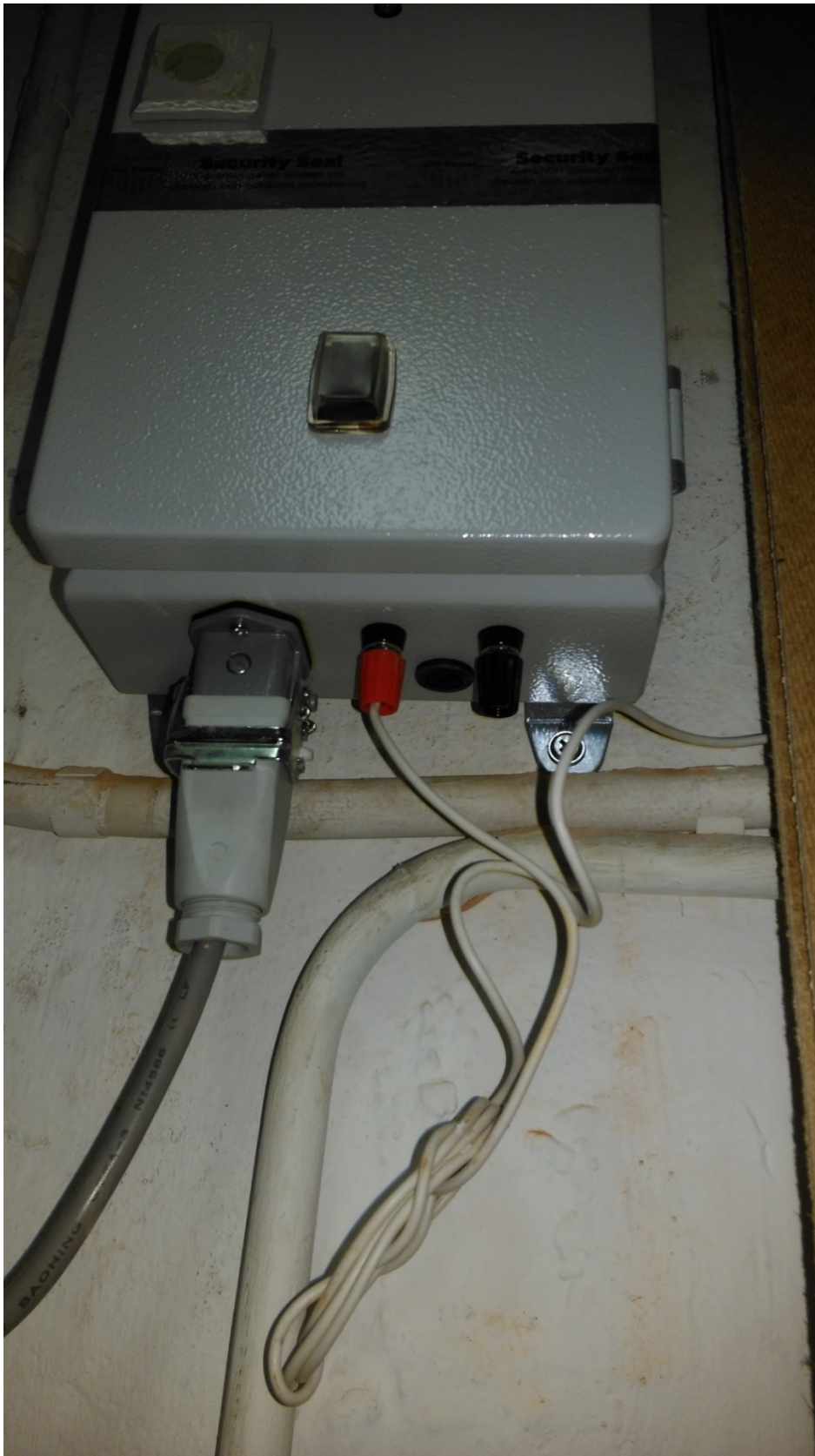
Figur 1.8 Endast kabel till anoder var anslutet till likriktarskåpet.
