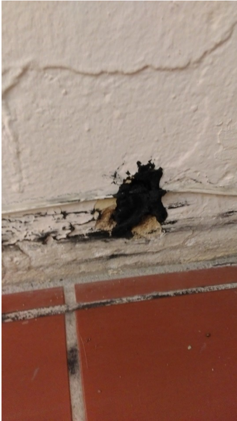
Figur 1.4 Närbild på anod. Det bedöms att grafitmassa använts som fyllning runt anoderna.
