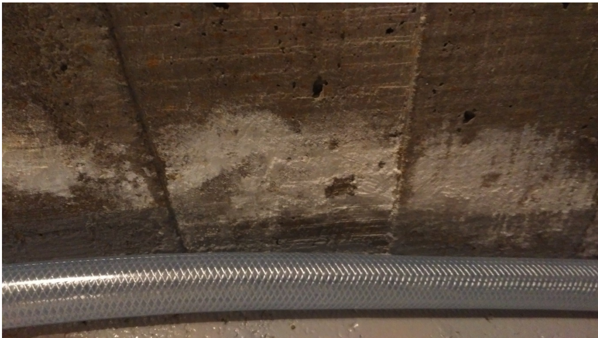
Figur 3.1 Kalkutfällning i vägg
