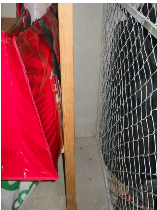
Figur 2.4 Bilden visar anslutning mellan golv och vägg i förrådsutrymmet.
