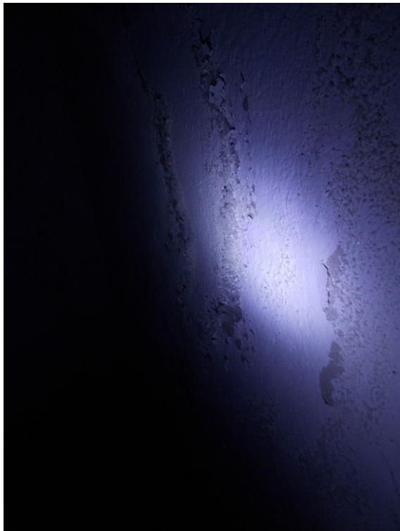
Figur 8. Röda korset: Väggen med kondens nära trappan
