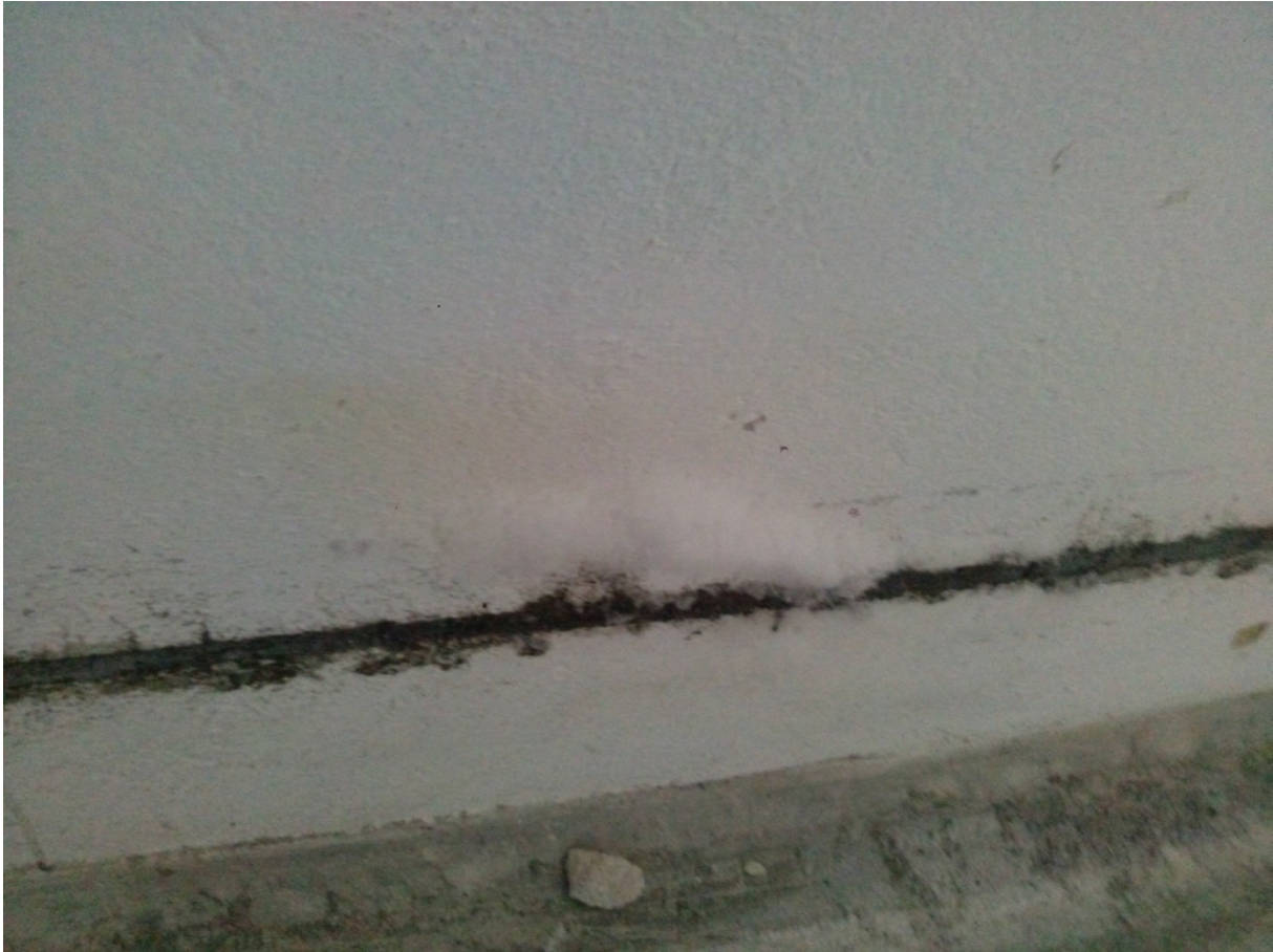
Figur Z Kalkutfällning på väggen
