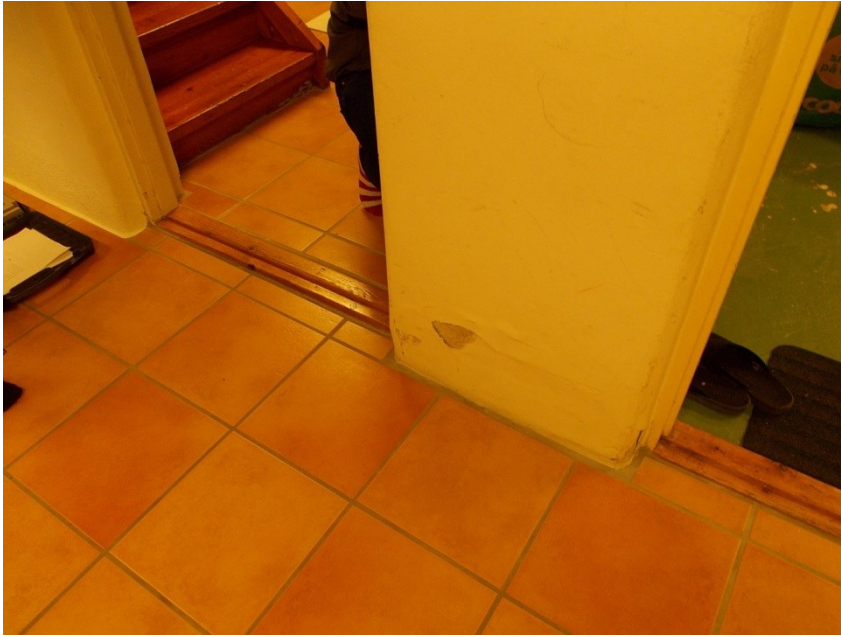
Figur 5.4 Bagarmossen: Putssläpp i vägg där installation saknas
