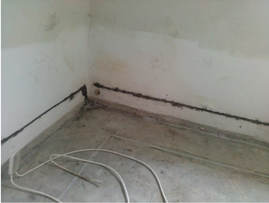
Figur 12. Här syns spåret i väggen och spåret i golvet där elektroderna sitter. Kablarna på bilden har inte med installationen att göra.
