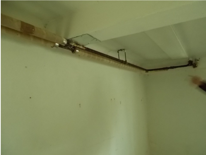
Figur 7. Röda korset: kallvattenrör med kondens
