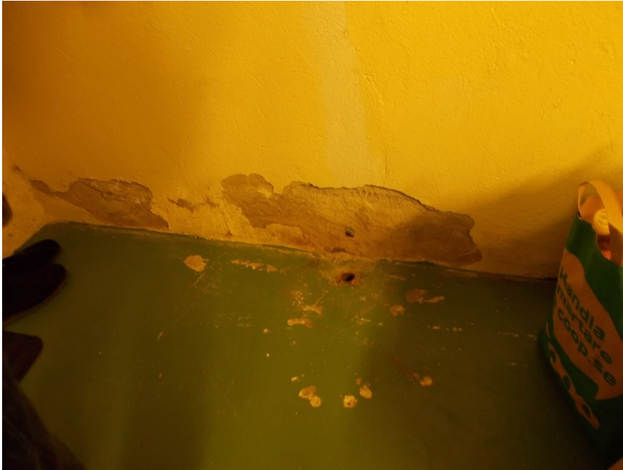
Figur 5.2 Bagarmossen: Putssläpp i vägg där installation saknas
