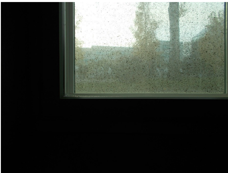
Figur 2. Röda korset: Fönster med kondens
