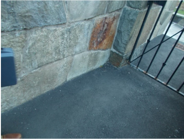
Figur 9. Gångväg med möjligt läckage
